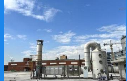
会社管理 VOCs廃棄処理
